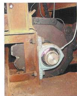
Étuve industrielle : graissage "en marche" des paliers.
