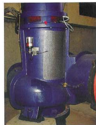
Lubrification centralisée de roulements de pompe HP.
